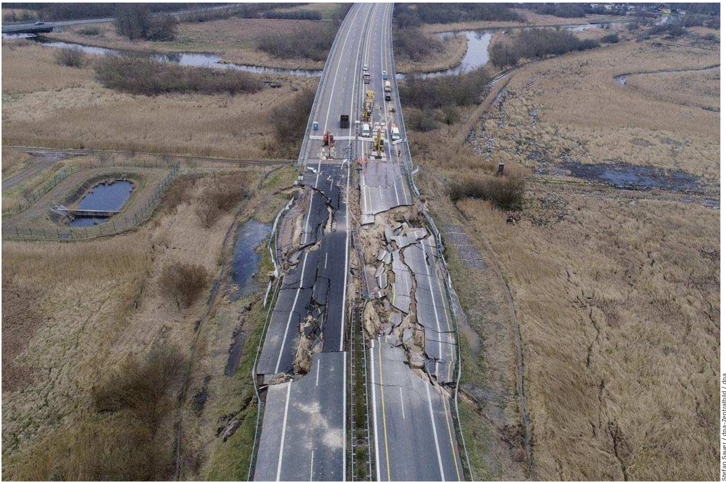
A 20 bei Tribsees in Mecklenburg-Vorpommern 2018: Viele machten die schnelle Mark
